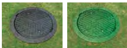
Tankabdeckung auf dem Rahmen der Schachtverlängerung
